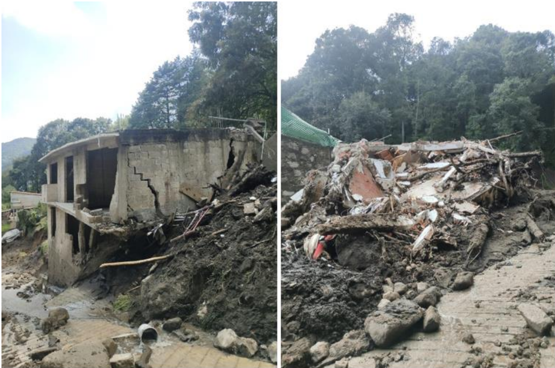
Figura 2. Fotos del deslizamiento de tierra ocurrido en el municipio de Jilotzingo (Estado de México), el 13 de septiembre de 2024 que provocó la muerte de 10 personas y 13 viviendas destruidas. Ejemplo de riesgo geológico de carácter exógeno.
